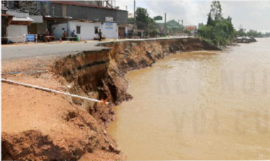
▲ Hình 6. Sạt lở đất ven sông (tỉnh An Giang)
